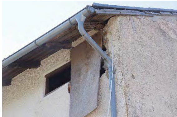
Abbildung 15: Einflugöffnung an der Nordwestseite des Hauptgebäudes, LaN 13.06.2024
