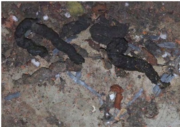
Abbildung 18: Steinmarderlosung im Dachbodenbereich, LaN 13.06.2024
