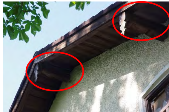
Abbildung 13: Vogelkots Spuren an Balken des Dachvorsprungs an der Westseite des Hauptgebäudes, LaN 13.06.2024
