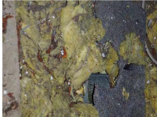
Abbildung 17: Herausgerissenes Dämmmaterial im Dachboden ehem. Schützenheims, LaN 13.06.2024
