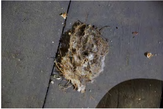
Abbildung 10: Nestspuren von Brutvögeln im Dachgeschoss, LaN 13.06.2024
